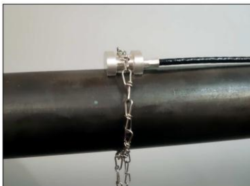
Датчик PT100, прикрепленный к трубе
